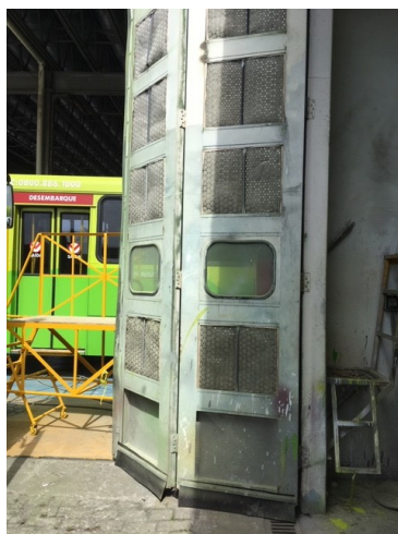
Fig.12 - Porta cabine com filtros
