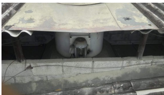
Fig.16 - Local instalado ventilador e motor
