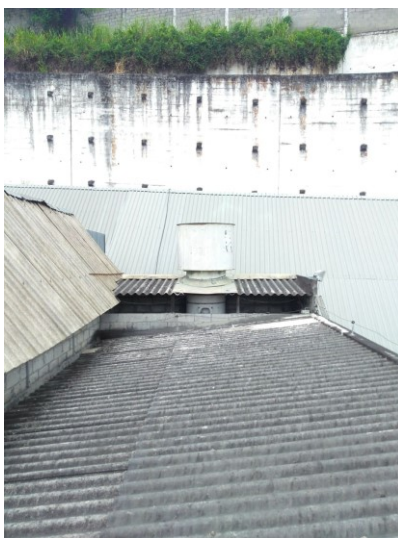
Fig.18 - Falta de chaminé
