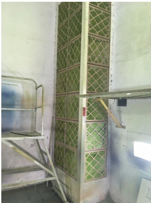
Figura 11 - Filtros da cabine – ao fundo, mesma estrutura lado esquerdo.
