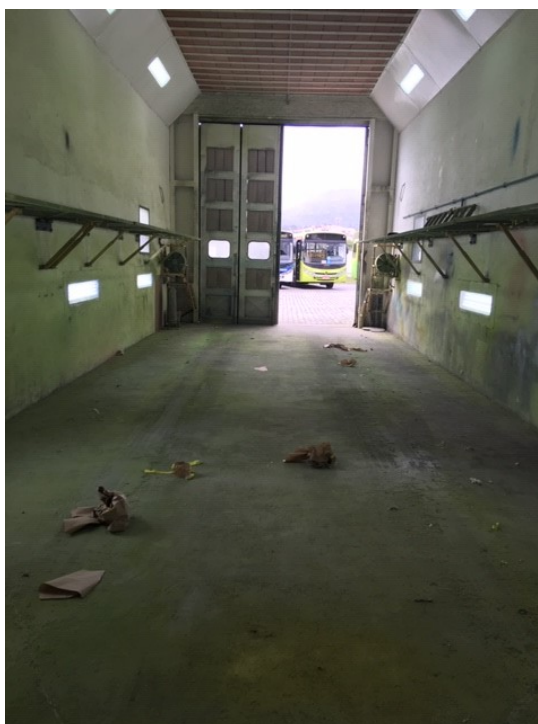
Figura 10 - Cabine de pintura – do fundo para fora.
